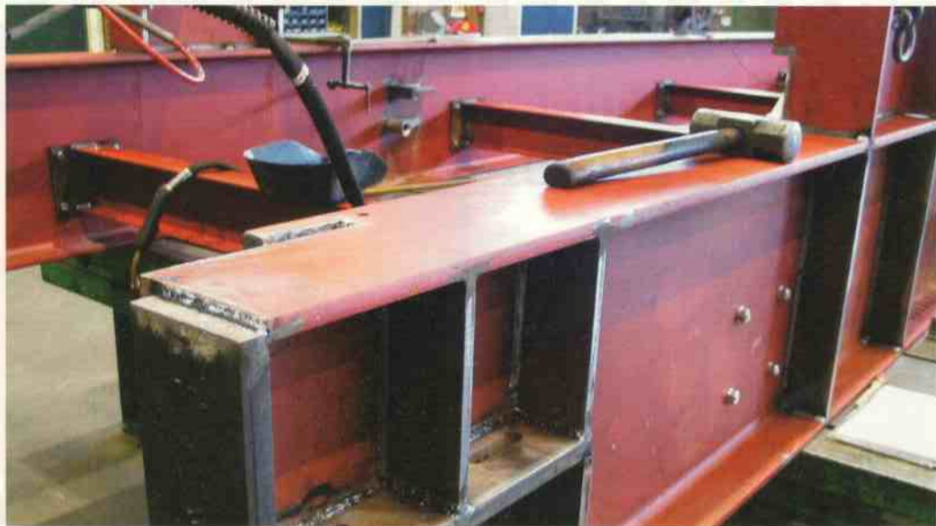
Grote frameonderdelen zijn al met een lasprimer aangeleverd. Er moet nog zoveel geschuurd en gelast worden dat reinigen en ontvetten noodzakelijk is
