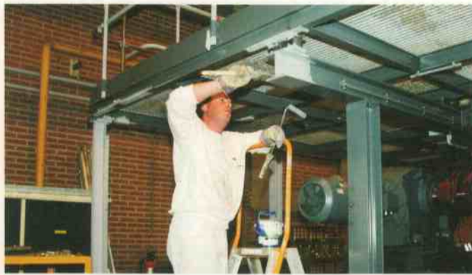
De immens grote machine van soms 12 meter lang met vele duizenden onderdelen wordt met de kwast en met de roller geschilderd
